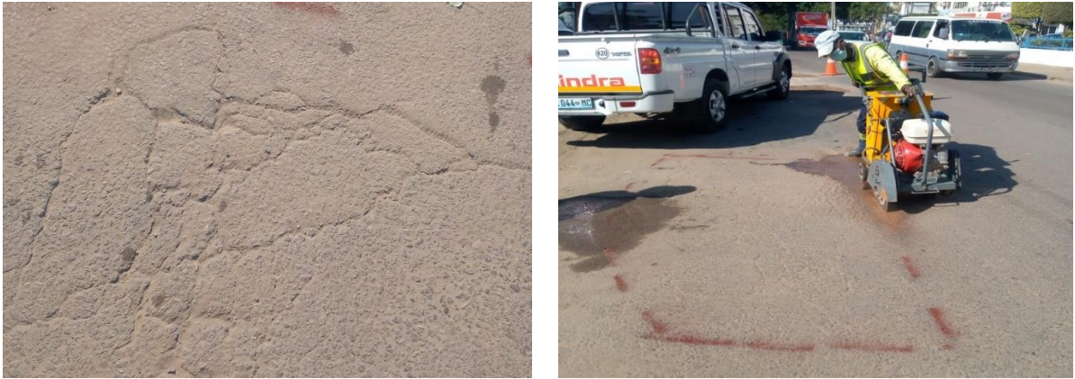
Figura 22: Fissuras do tipo pele de crocodilo na Av. de Trabalho; Fonte: Autor
