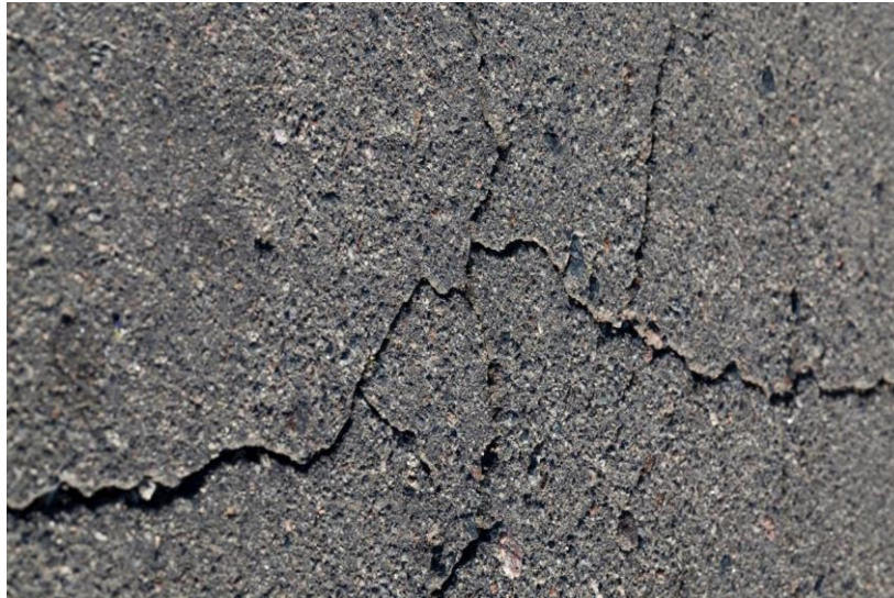
Figura 15: Fissura linear; Fonte: Autor
