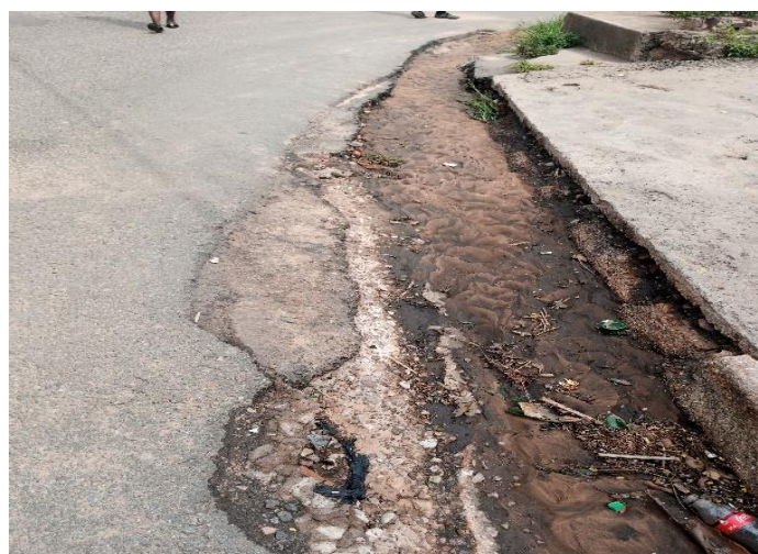
Figura 20: Ruptura do bordo, na Av. de Trabalho; Fonte: Autor
