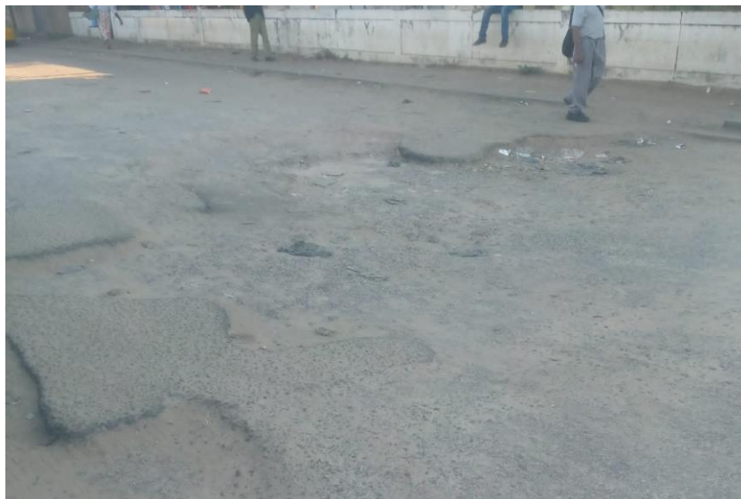
Figura 19: buracos na Avenida do Trabalho; Fonte: Autor
