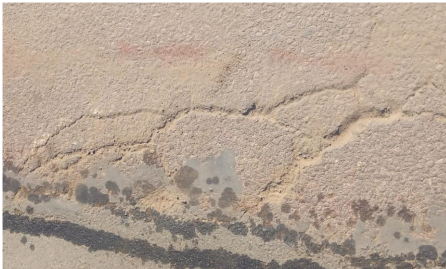
Figura 23: Fissuras longitudinais; Fonte: Autor
