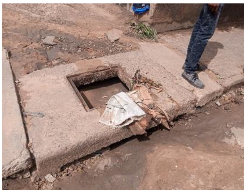
Figura 37: Sarjeta danificada; Fonte: Autor
