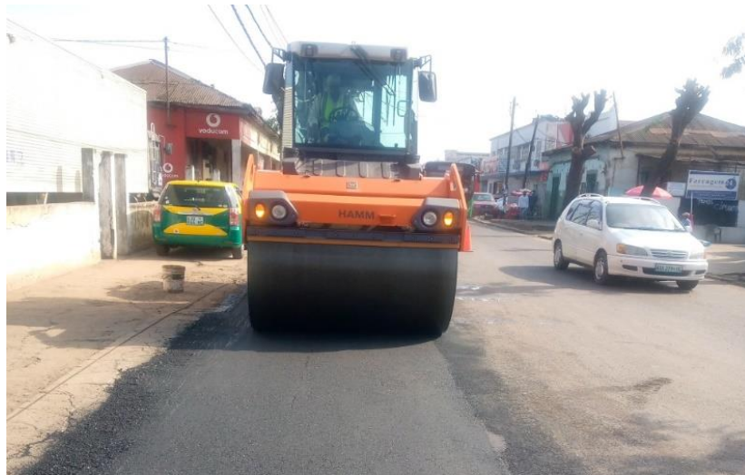
Figura 35: Compactação do betão betuminoso com o cilindro de rasto liso; Fonte: Autor
