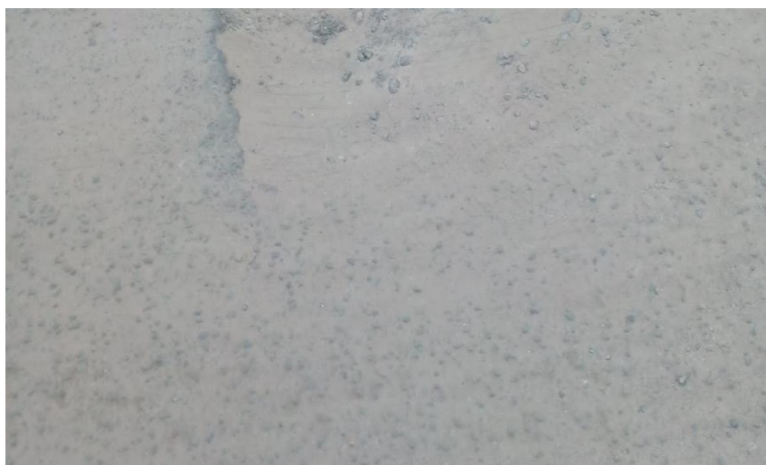
Figura 18: desagregação superficial; Fonte: Autor
