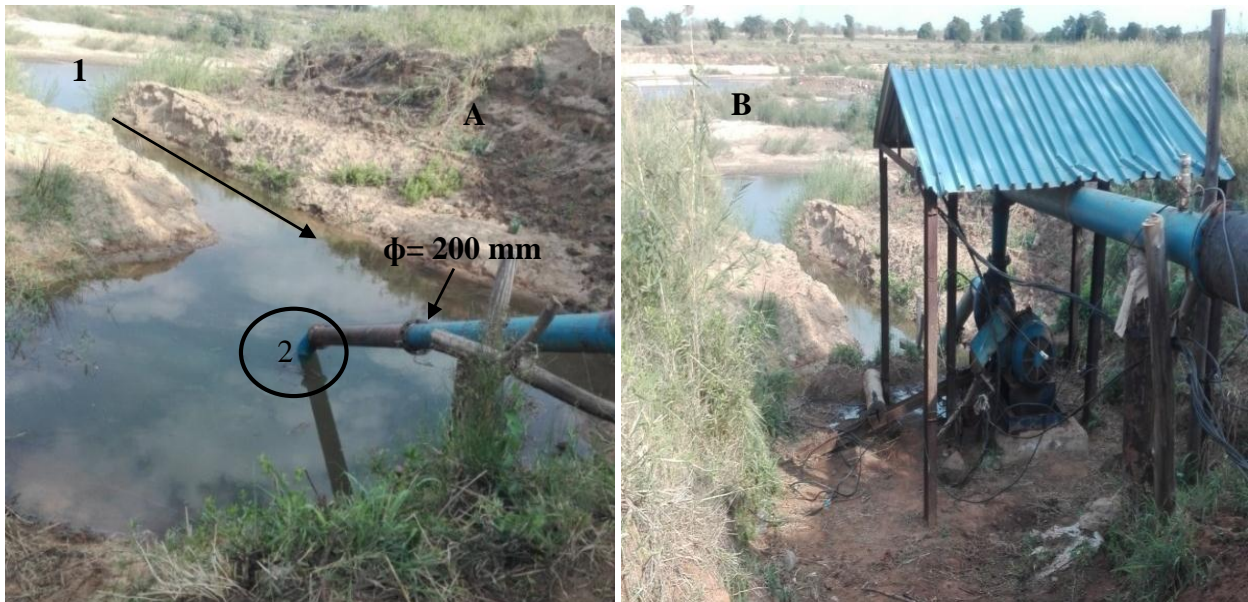
Figura 8. Captação (A) e a electrobomba (B) actualmente em funcionamento (Fonte: Autor).
