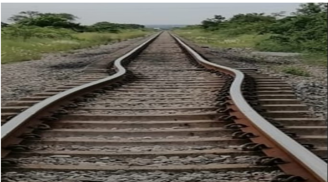
Figura 33: Vista de garrote de via no trecho Movene - Chanculo (Fonte: Autor, 2022) desalinhamento de via
