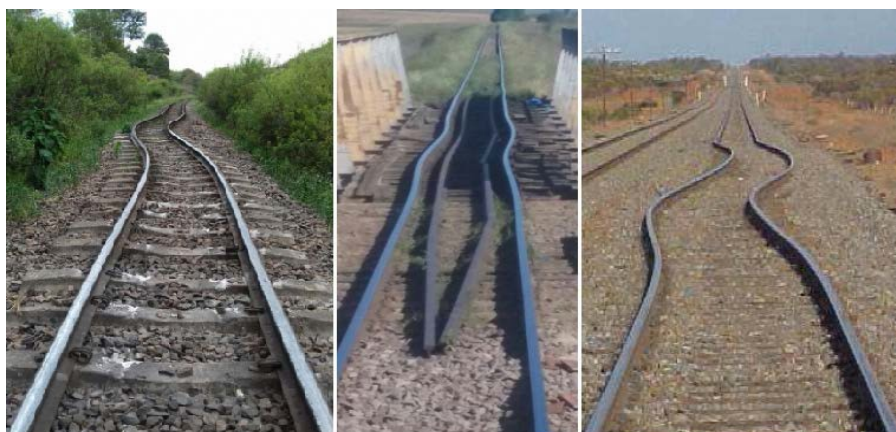
Figura 20:Exemplos de flambagem lateral de linha férrea (Fonte: )
