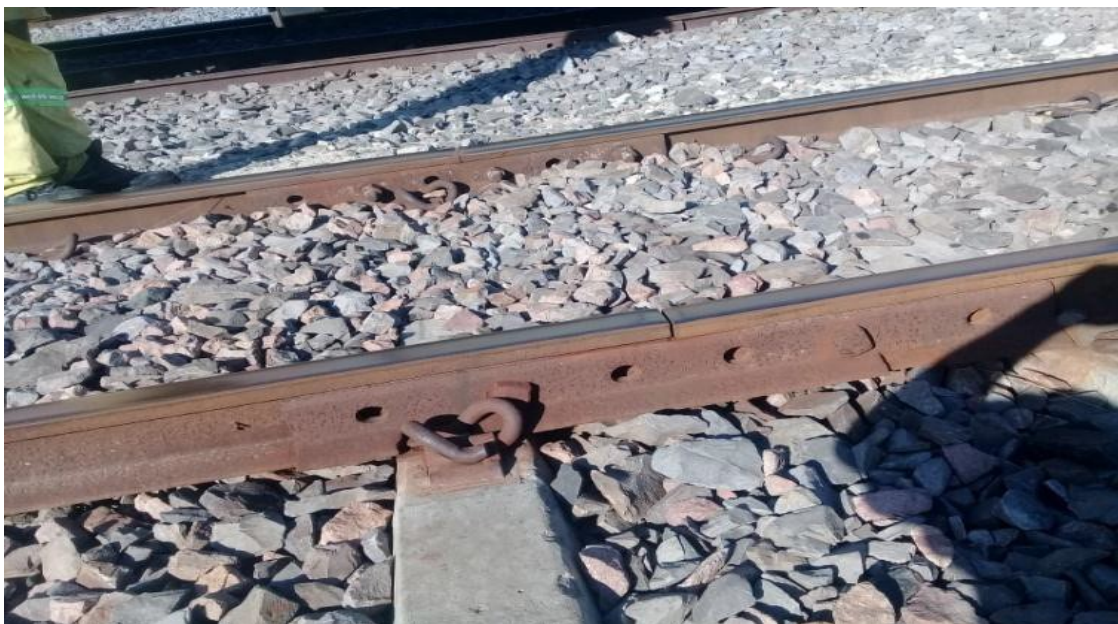
Figura 32: Juntas sem parafusos corroídos e incompletos (Fonte: Autor, 2022)
