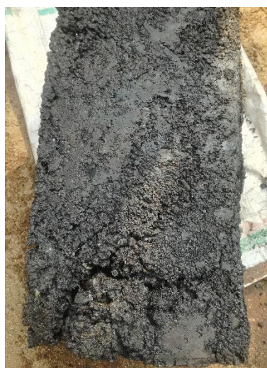
Figura 37 - Resultado do bloco em Mau estado apresentado rachas. Fonte: autor, 2022.
