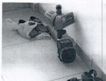
Figura 4 – Condições de armazenamento da bomba.
