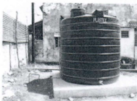
Figura 3 – Depósito assente numa base de betão.
