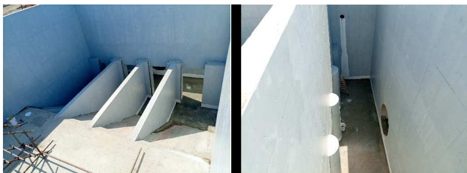
Figura 4.7. Câmara de chegada para elevação de esgoto da ETAR de Infulene (Fonte: Autor)
