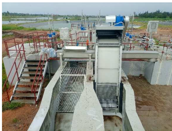
Figura 4.8. Câmara de grades da ETAR de Infulene (Fonte: Autor)
