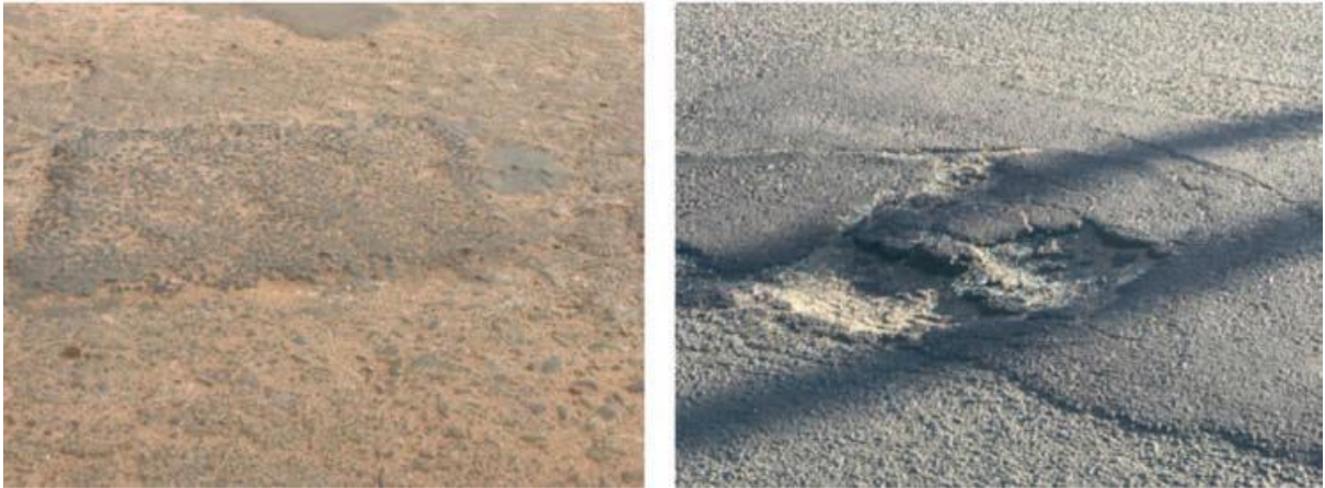
Figura 10. Remendos em pavimento. (ANE 2021)
