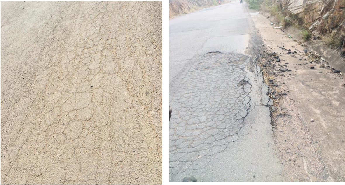
Figura 31. Fissuras do tipo pele de crocodilo. (Autor 2021.)
