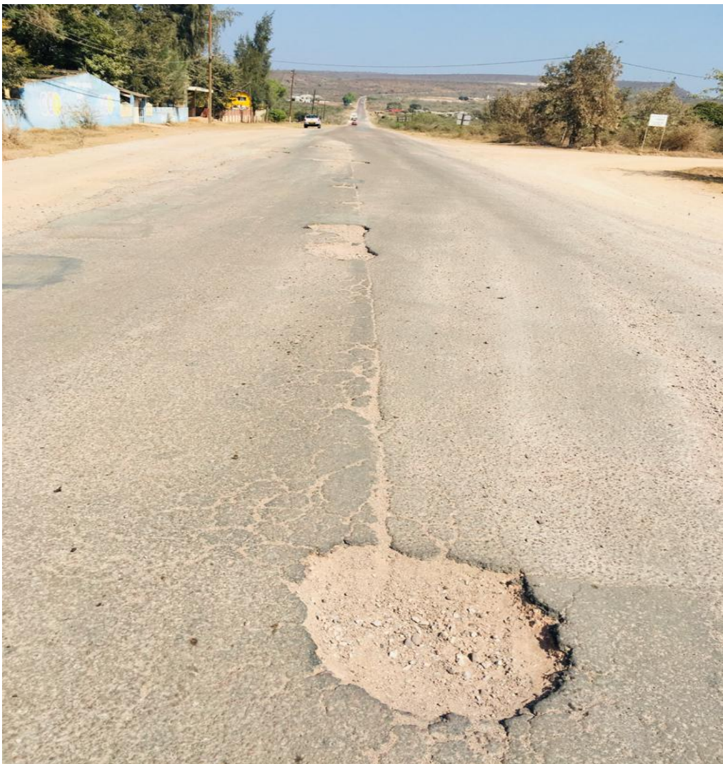
Figura 25. Múltiplas patologias, entrada da pedreira Progosa. Km 5+700. (Autor 2021)
