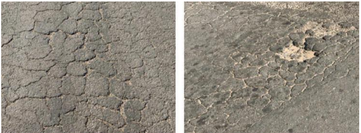
Figura 14. Fissuras do tipo pele de crocodilo. (ANE 2021)
