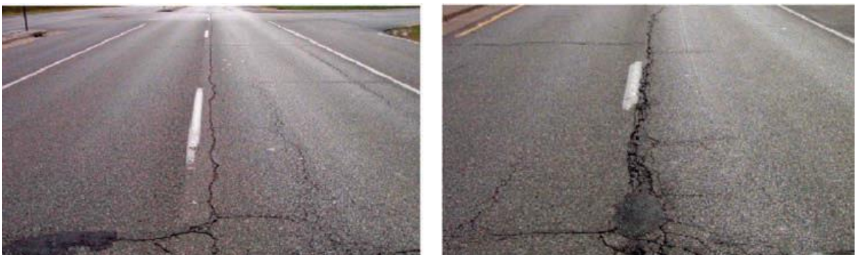
Figura 15. Fissuras longitudinais. (ANE 2021)
