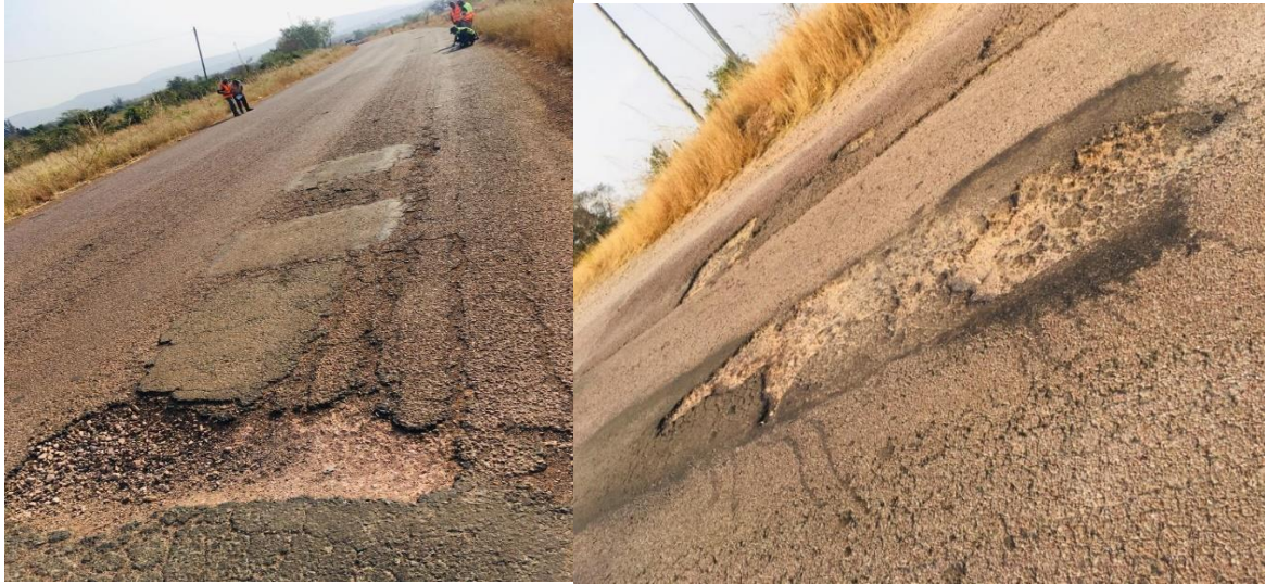
Figura 36. Desagregação da superfície. (Autor 2021.)
