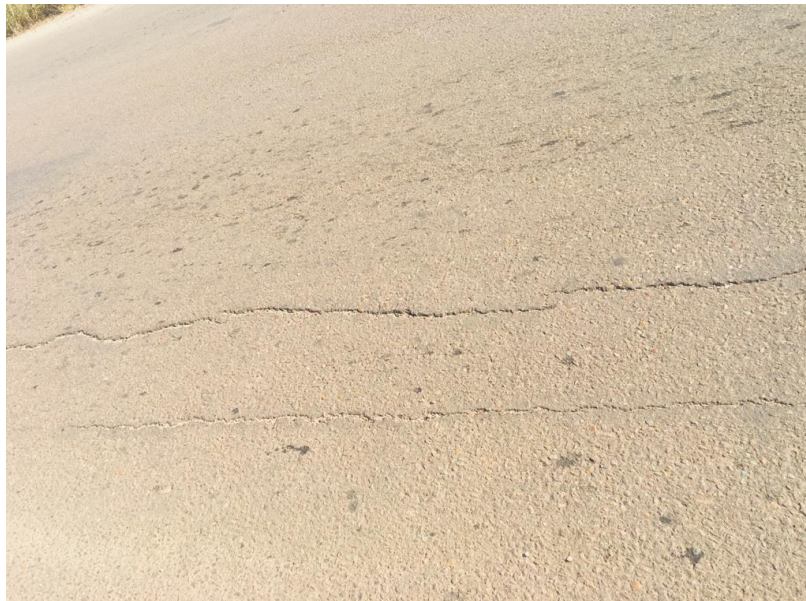
Figura 32. Fissura Longitudinal. (Autor 2021. )
