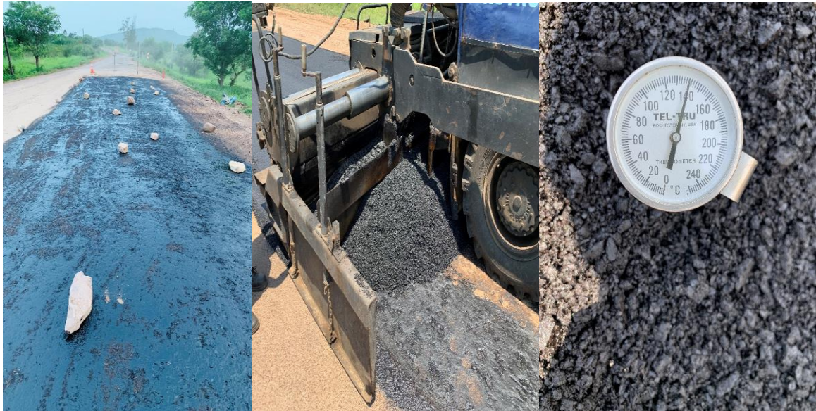
Figura 29. Rega de impregnação MC-30, e aplicação de Betão Betuminoso a Quente. (Autor 2021.)
