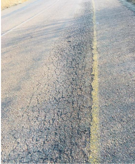
Figura 33. Afundamento do trilho. (Autor 2021.)
