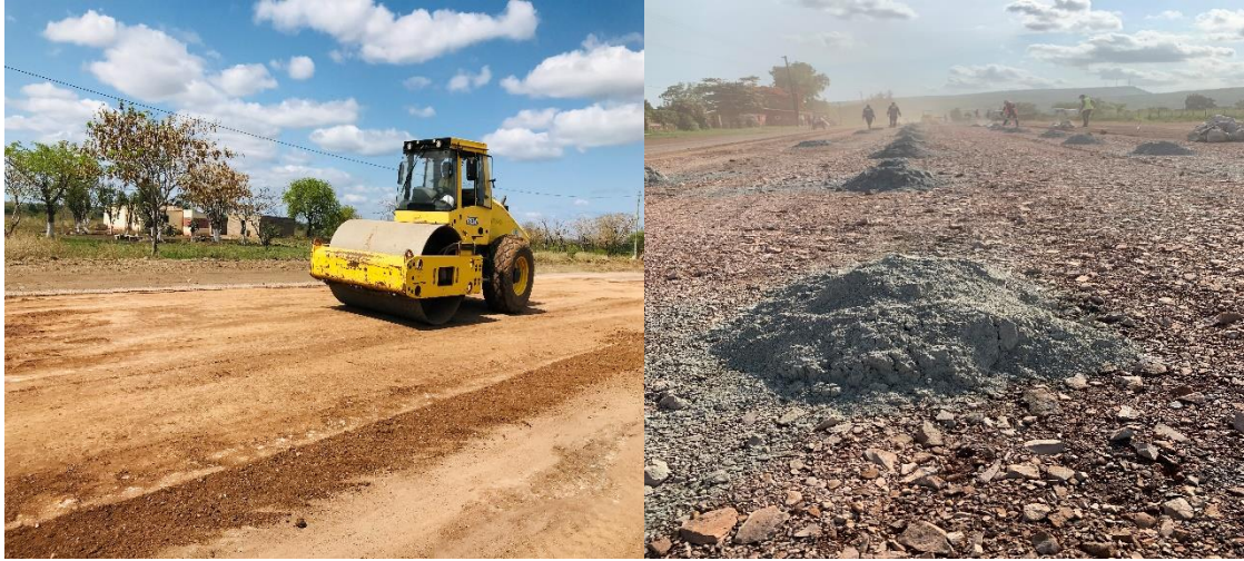
Figura 28. Compactação em camadas com recurso a cilindro e estabilização com cimento Portland 3%. (Autor 2021.)
