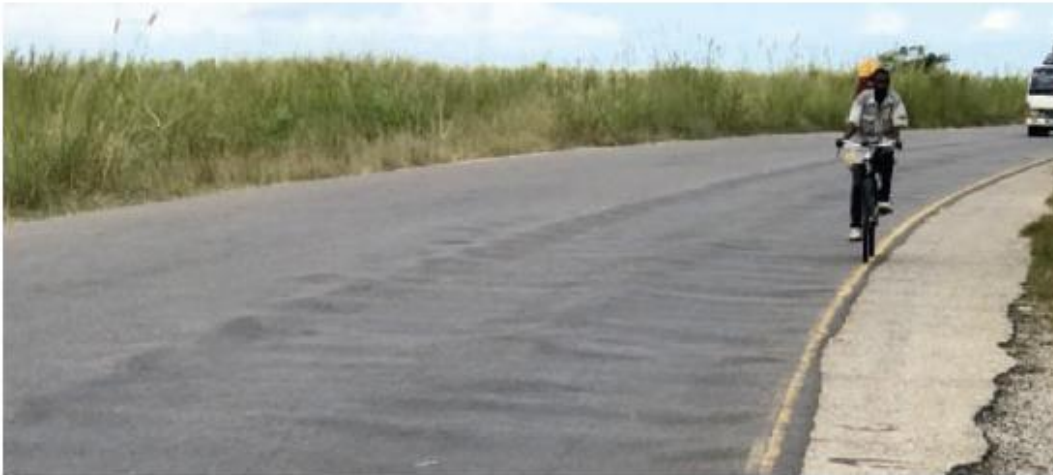
Figura 11. Corrugações/Ondulações em pavimentos asfaltados. (ANE 2021)
