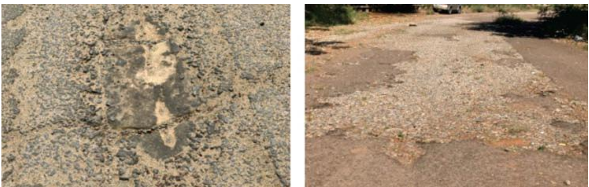
Figura 7. Desagregação da superfície. (ANE 2021)
