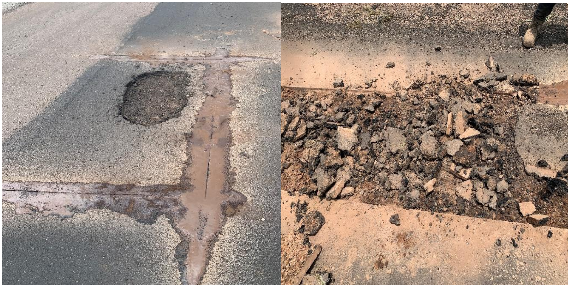
Figura 39. Marcação, Corte e remoção de todo o material danificado e a limpeza do fundo do buraco. (Autor 2021.)
