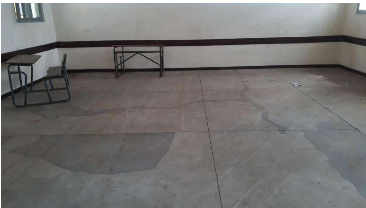
Fig. 27: Pv em reacção alcali-agregado, e reparo mal executado; EPC - Bunhiça (Fonte: Autor).
