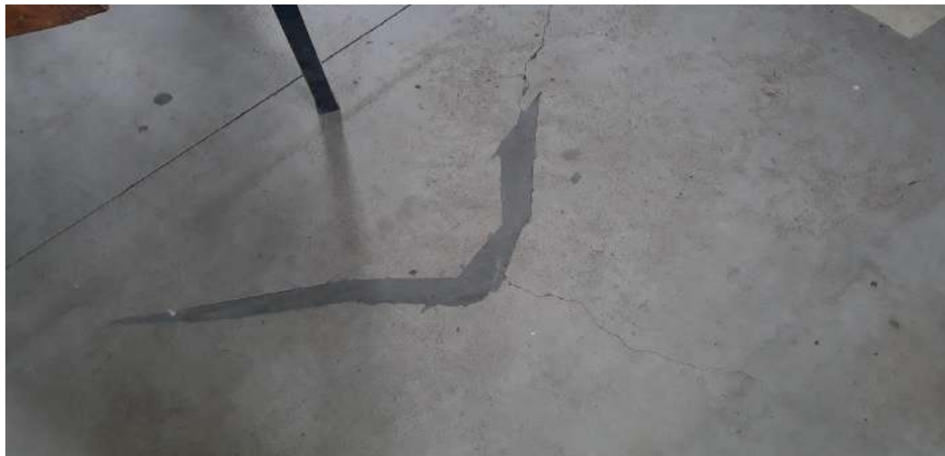
Fig 19: Reparo mal executado (Fonte: Autor)
