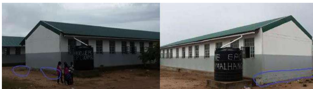
Fig. 25: Erosão no edifício. Fig. 26: Fendilhação do edifício (Fonte: Autor)
