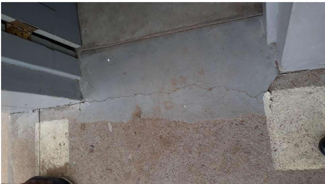
Fig. 28: Fissura em remendo emergencial; EPC Ka Mahlanguene (Fonte: Autor)
