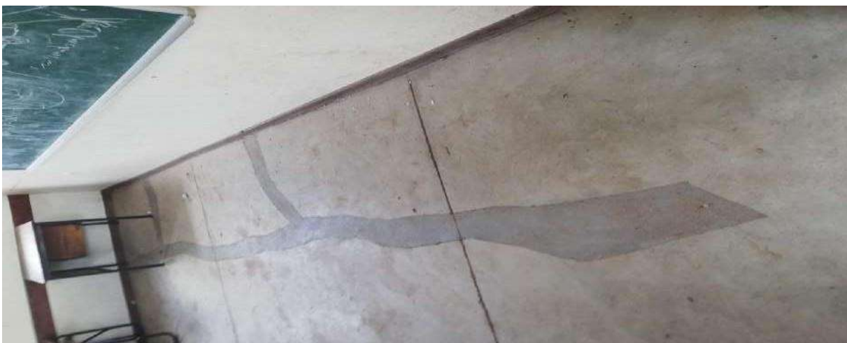
Fig. 31: Reparo mal executado em Trincas por RF (Fonte: Autor)
