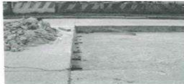
Fig. 15: Trinca por desalinhamento da Barra de Transferência. (Fonte: Quirino, 2013)
