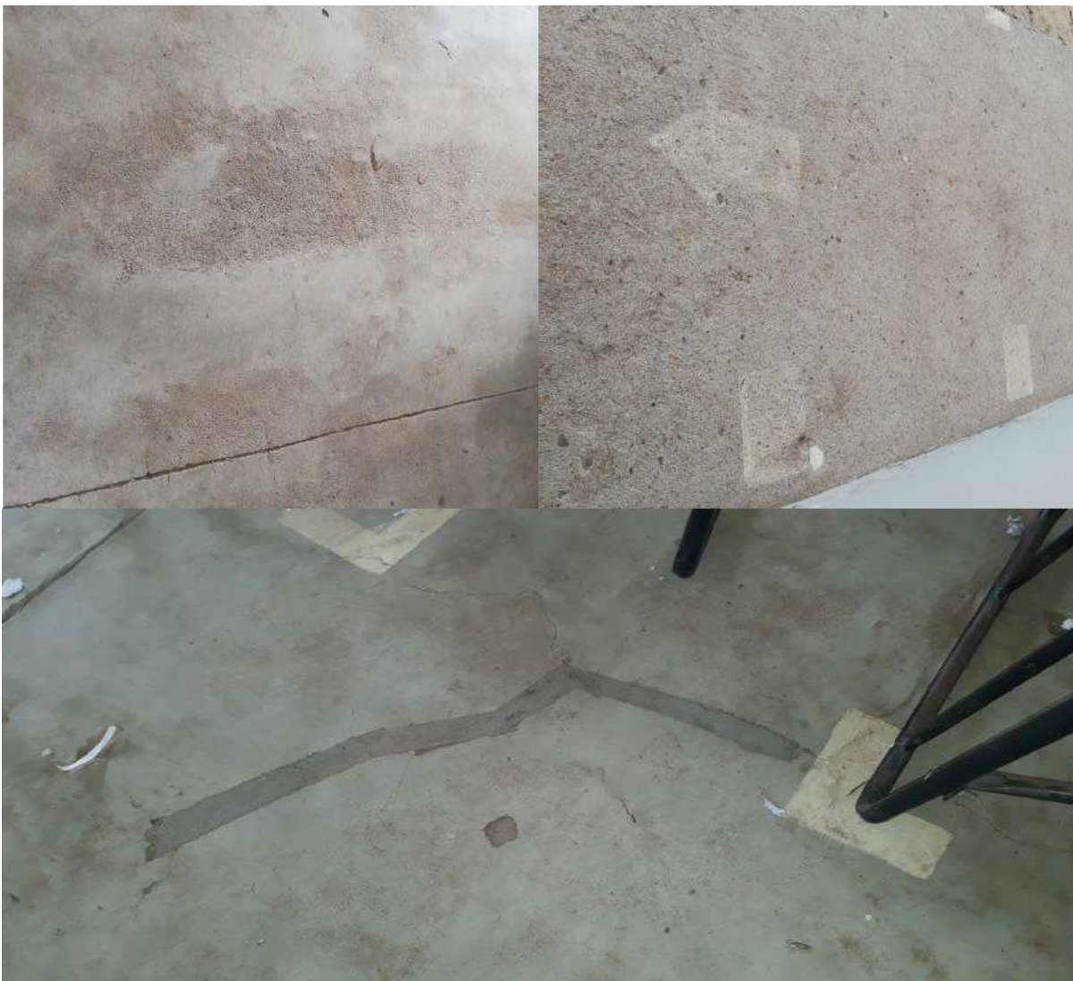
Fig. 29: Delaminação do Pv; EPC Ka Mahlanguene(Fonte: Autor)
