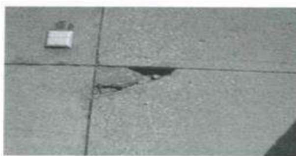
Fig. 13: Trinca por atraso ou má execução da junta. (Fonte: Silva, 2008)
