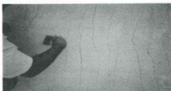
Fig. 12: Fissuras da Retracção Plástica (Fonte: Silva, 2008)
