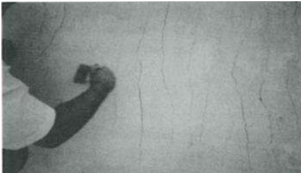
Fig 10: Fissuras em pavimento (Fonte: Silva, 2008)
