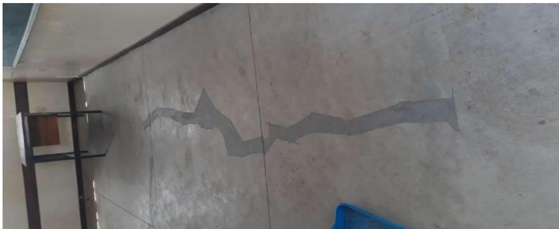
Fig. 32: Reparo mal executado em Trincas por RF; EPC Bunhiça (Fonte: Autor)
