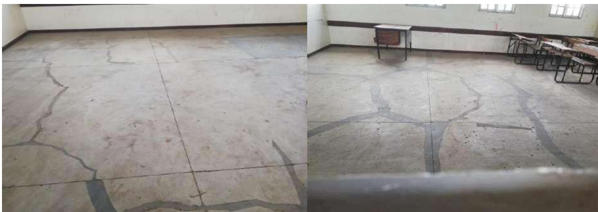
Fig. 33: Trincas mal reparadas; EPC Bunhiça e Ka Mahlanguene (Fonte: Autor)
