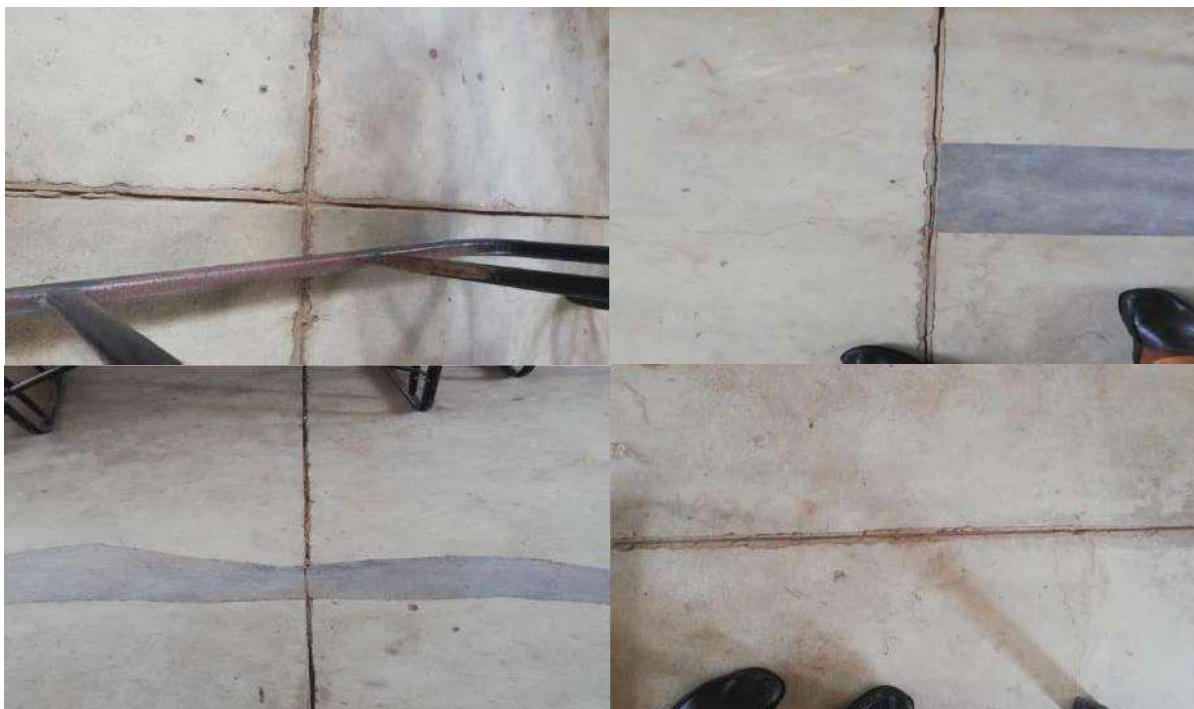
Fig. 35: Juntas mal executadas; EPC Ka Mahlanguene (Fonte: Autor)
