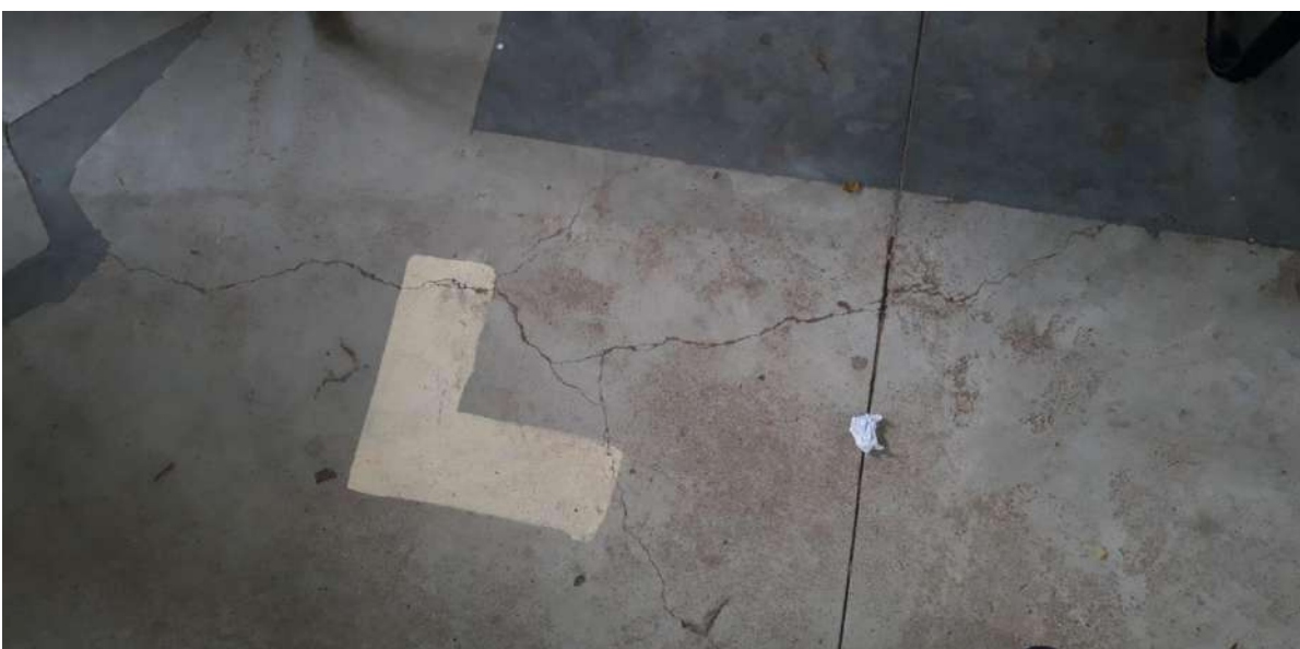
Fig. 30: Delaminação e fissuração do Pv; EPC Ka Mahlanguene (Fonte: Autor)
