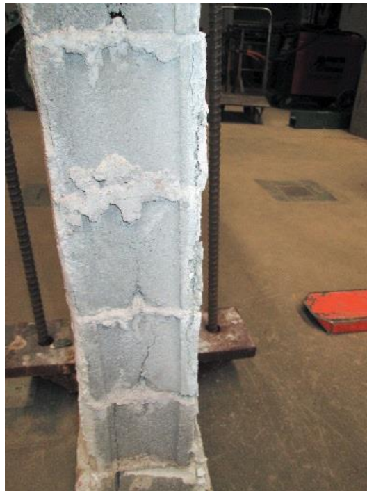
Anexo 6: Provete 2- Fissuras verticais no meio do bloco e sinais de descolamento na face exposta (lado direito) (Fonte: LOPES, 2017)
