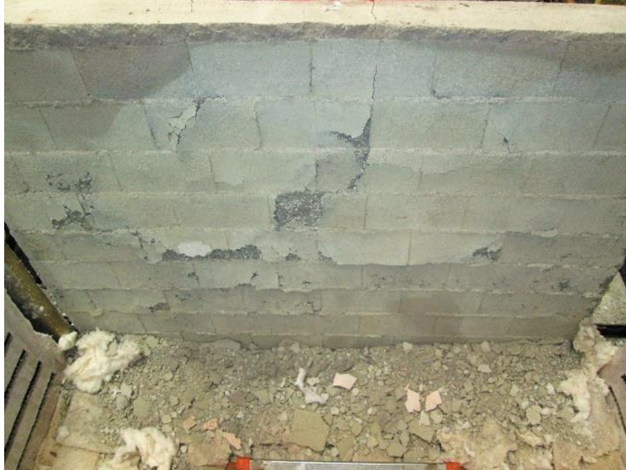
Anexo 5: Provete 2 - Sinais de descolamento na face exposta ao incêndio (Fonte : LOPES, 2017)
