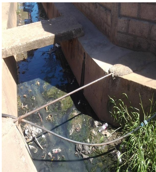
Figura 6. Valas de drenagem do bairro sujas com tubos de água para o consumo da população.
