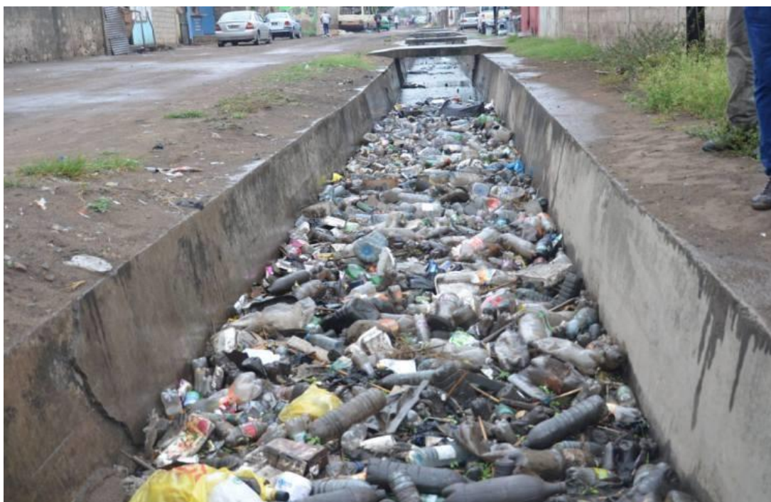
Figura 1. Vala de drenagem do Bairro da Mafalala.
