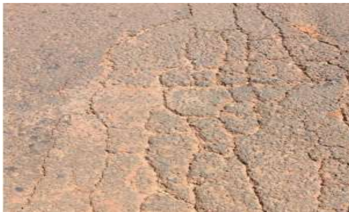
Figura 9: Pavimento com fissuras do tipo pele de crocodilos (SILVA, 1973).
