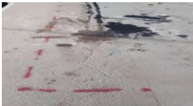
Figura 17: Fissuras, Fonte (Autor, 2022)
