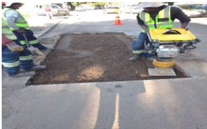
Figura 20: Tapamento de buraco, fonte (autor 2022)
