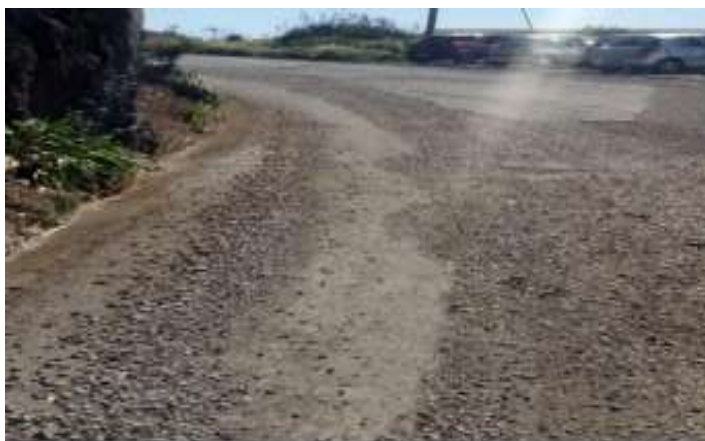
Figura 7: Estado de desagregação de um pavimento, (SILVA, 1973).
