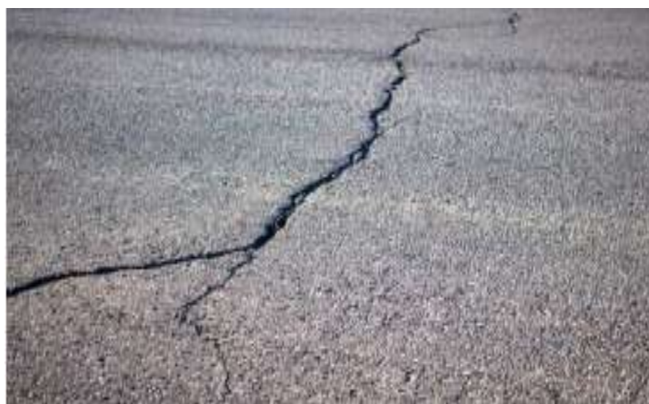
Figura 10: Fissura linear. Fonte (autor 2022).
