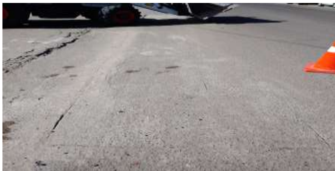
Figura 23: desgaste do Pavimento, Fonte (autor 2022)
