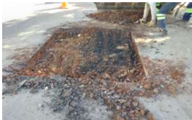
Figura 19: Corte da camada de pavimento esburacada para correcção do buraco, Fonte (autor 2022).
