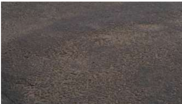
Figura 6: Desgaste do pavimento, (BERNUCCI & SOARES, 2006).
