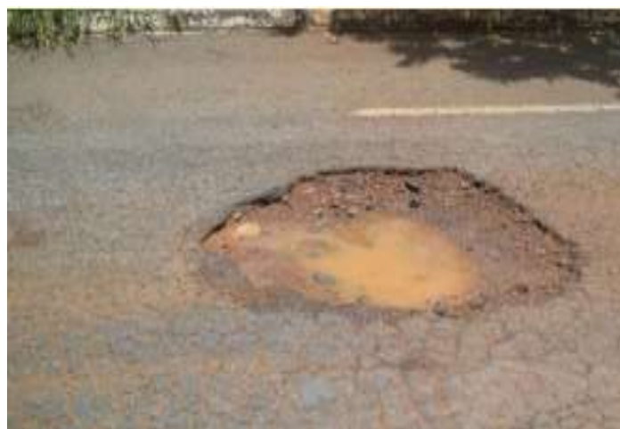
Figura 12: Estado de avançado de defeito buraco, (SILVA, 1973).
