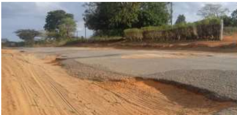
Figura 14: Estrada de ruptura de bordo, (SOUSA).
