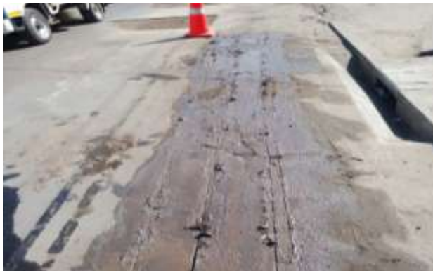
Figura 18: Camada da faixa de rodagem, afundamento das trilhas de rodas, Fonte (autor 2022)
