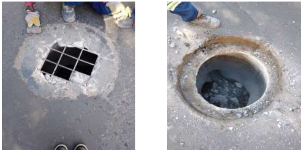
Figura 26: Caixa de inspecção: Obstruções, acúmulo de folhas, lixo, sedimentos ou outros materiais nos sistemas de drenagem(Autor, 2022).
